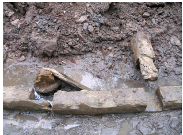
Kuva 7. Pysty- ja poikittaishirret eivät ole riittäneet pitämään pitkittäishirttä paikoillaan, vaan se on haljennut ja liikkunut kohti kanavaa. Kuvaussuunta: SE-NW.
