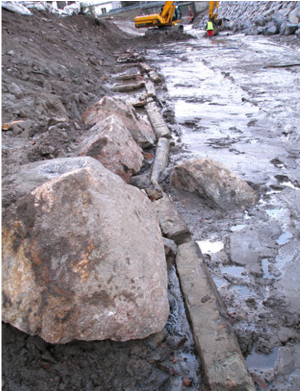
Kuva 8. Pitkittäishirsi ei ole päässyt liikkumaan kuvassa oikealla olevan kiven takia vapaasti, joten se on halkeillut ja taipunut voimakkaasti. Vasemmalla olevat kivet ovat alkuperäisen kiviliuskan alimpia kiviä. Kuvaussuunta: NE-SW.
